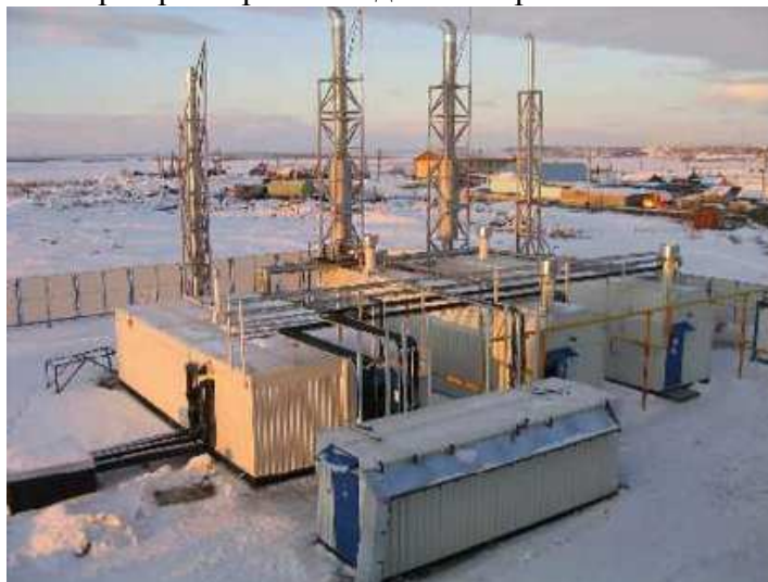
Рис.8. Блочно-модульная (контейнерная) мини-ТЭЦ
