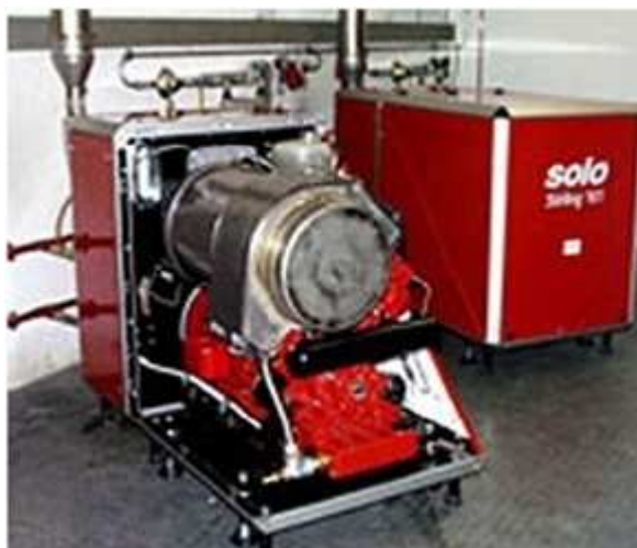
Рис.5. Когенерационная установка на баз поршневого двигателя.
