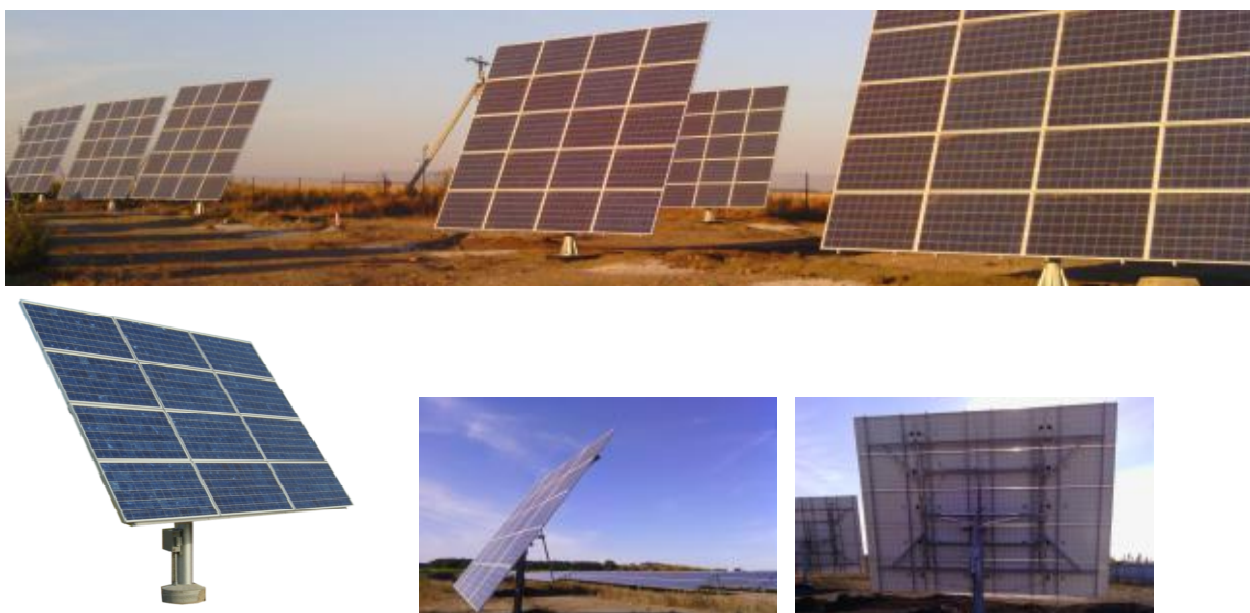
Рис. 3 - Подвижные опоры (трекеры) для установки солнечных батарей
