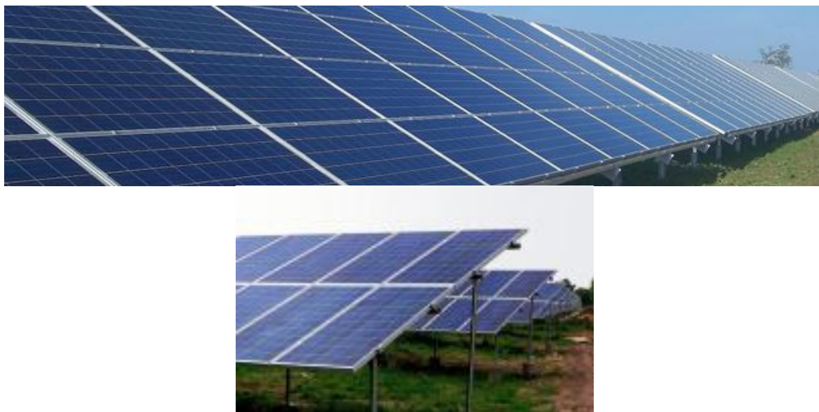
Рис. 2 – Солнечные панели (батареи) на фиксированных опорах
