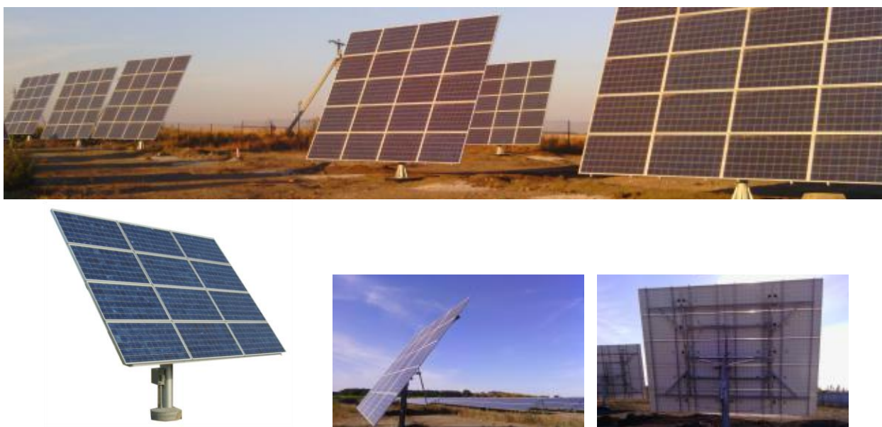
Рис. 3 - Подвижные опоры (трекеры) для установки солнечных батарей
